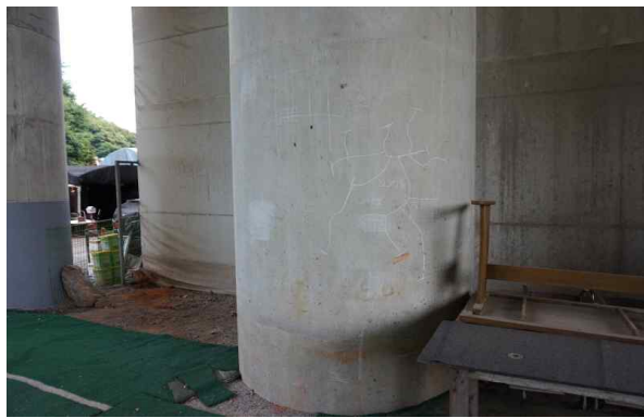
교각 망상균열 P1
