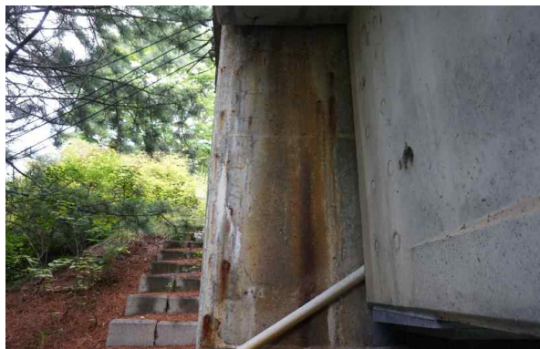
교대 망상균열 및 백태 A2
